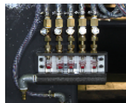
金型冷却水 フローメーター
