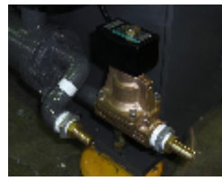
作動油温度制御用 冷却水バルブ
